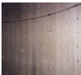
Acero ACE 439A como revestimiento de un tacho de cocimiento de acero cefero en un ingenio después de 12 años de utilización
