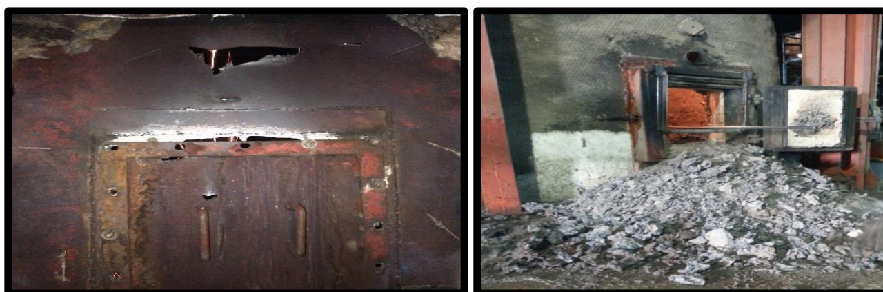
Figura 5. A la izquierda daños en carcasa y rotor de ventilador de tiro inducido por exceso de tierra, a la derecha tierra sacada de horno de calderas.
